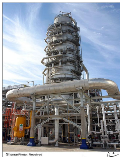
شکل ۱-۱ یک نمونه از زیرساخت های حیاتی
